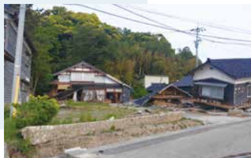
地震で倒壊した家屋（石川県珠洲市）
